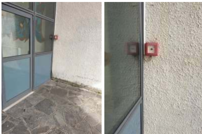
Pulsante di sgancio energia elettrica
