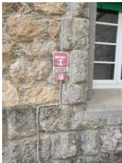
Pulsante di sgancio energia elettrica
